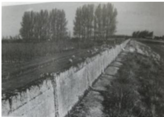
(afb. 3 III. 8. Dellebeke 2010. Restant van de muraltmuur op de voormalige zeedijk van de polder Nieuw-Sint Joosland)
